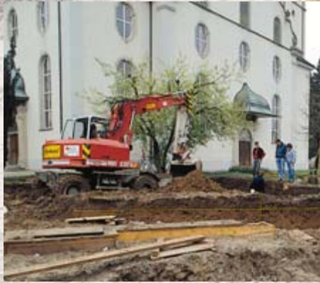
Kosten- und Termindruck verlangen den Einsatz zweckmässiger Hilfsmittel. Bei Sondierungen und beim Abtrag fundleerer Deckschichten kommen beim «überwachten Aushub» oft Bagger zum Einsatz.
